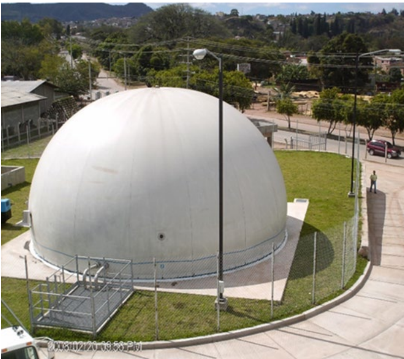
Figura 57 Balão de armazenamento do UASB
