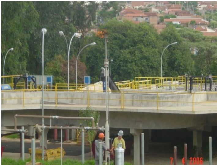
Figura 56 Flare do reator UASB de Matão (SP)
