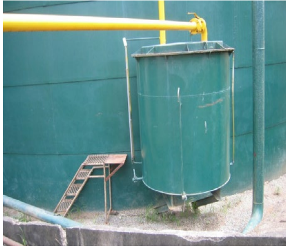
Figura 55 Corta chama já construído com visor e manômetro
